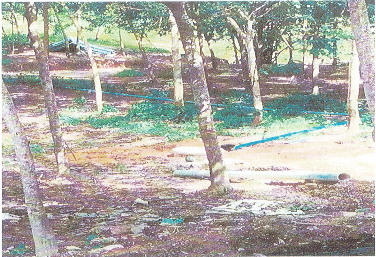
ภาพถ่ายบ่อพักและการกำจัดน้ำเสียลานรับซื้ออย่างถาวร (คุ่มโนนป่ายาง ม.๙)
